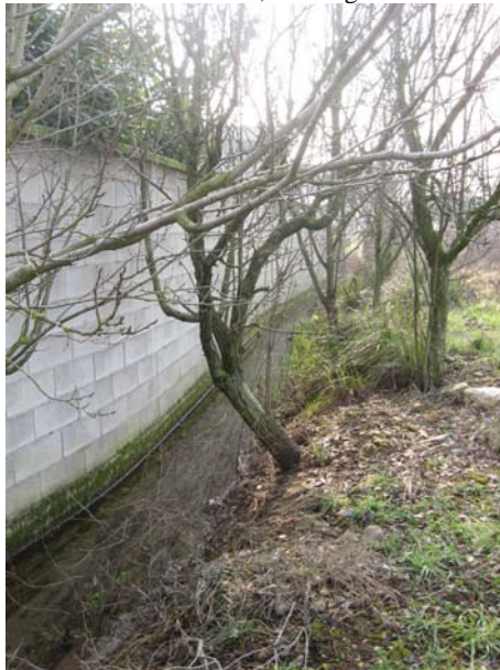
Foto 13: Vaso Casaletta, ingresso in Ognato. 13
