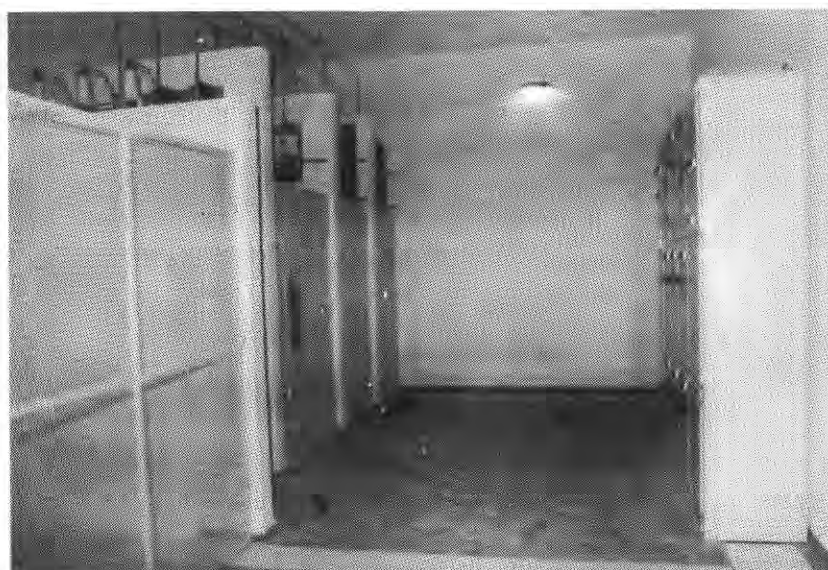
Interno della nuova cabina di trasformazione di via Monti. La ripresa fotografica mostra solo una metà della cabina essendo l'altra esattamente uguale. Sono visibili il quadro di distribuzione a bassa tensione e parzialmente le apparecchiature di sezionamento della media tensione, relative alla VI zona. Uguali apparecchiature sono installate per la distribuzione alla VII zona.
