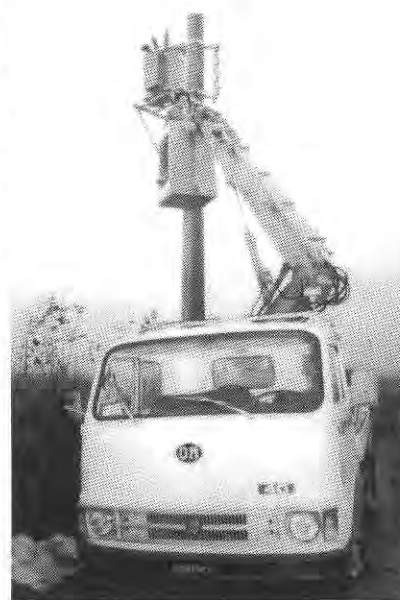
Cabina di trasformazione su palo derivata da linea a M.T. in fase di allestimento. È visibile il trasformatore da 15.000/380 V. da cui si dipartiranno le linee di distribuzione a bassa tensione.
