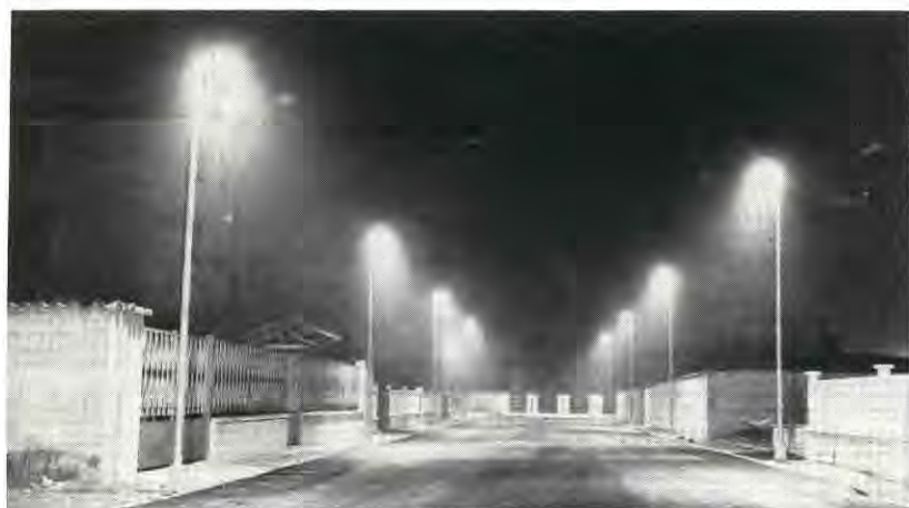
Quartiere in fregio alla Via Milano - particolare della illuminazione pubblica di una strada interna dell'insediamento residenziale - artigianale ad interventi ultimati.
