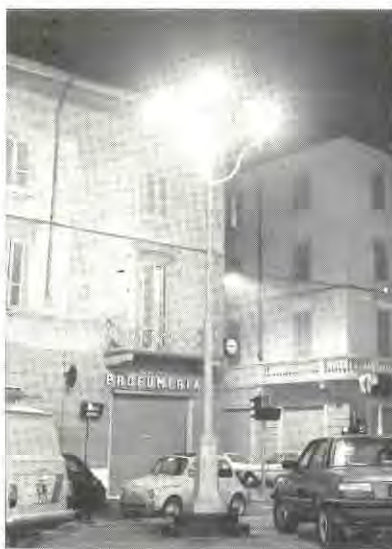
Piazza Garibaldi - un particolare del nuovo impianto di illuminazione realizzato mediante la installazione su ognuno dei 4 sostegni posati agli angoli della piazza di quattro lampioni in fusione di ottone con parti in rame ed inox e vetro in cristallo temperato, in stile d'epoca, modello "Mazzini" della Tagliafico di Genova.
