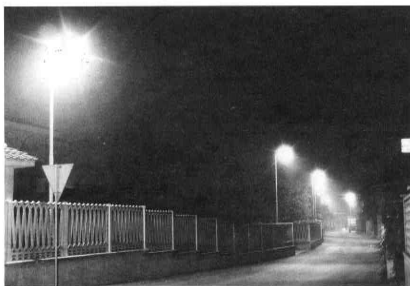
Impianto di illuminazione in Via Del lupo.
