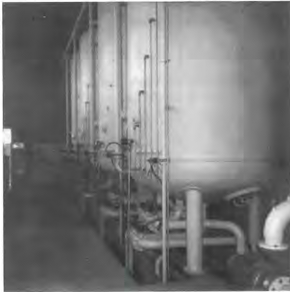
Impianto di potabilizzazione del nuovo pozzo Stadio.
