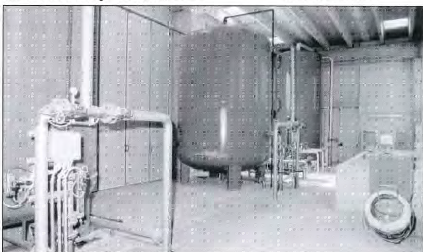
Nuovo impianto di trattamento di acqua potabile in via Bergamo.
