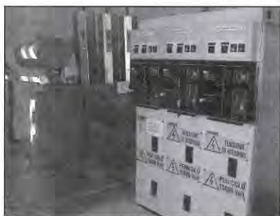
1. cabina elettrica di trasformazione in via Montegrappa.
