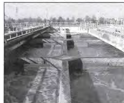
6. nuovo depuratore comunale - vasche trattamento liquami.
